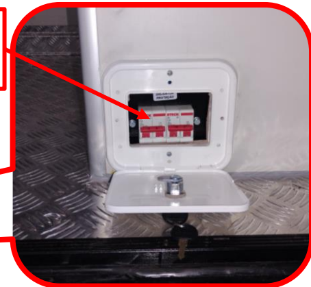
DISJUNTOR BIPOLAR - DJ1 32A
